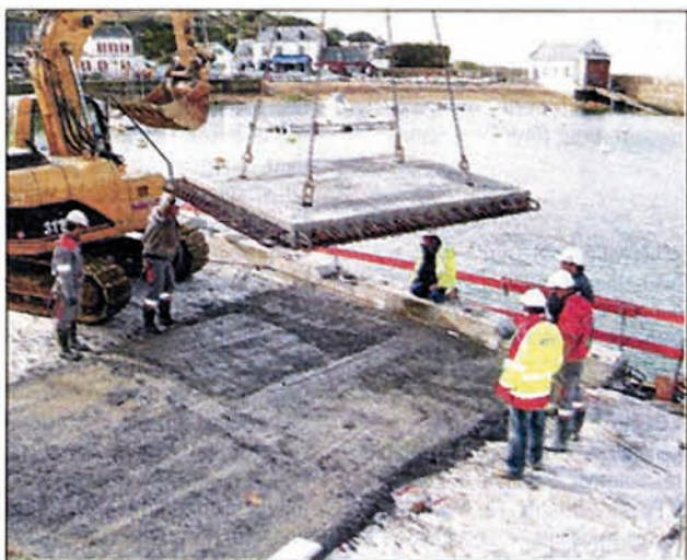
Jeudi, à 15 h, la première dalle de cinq tonnes est déposée délicatement sur la cale.
